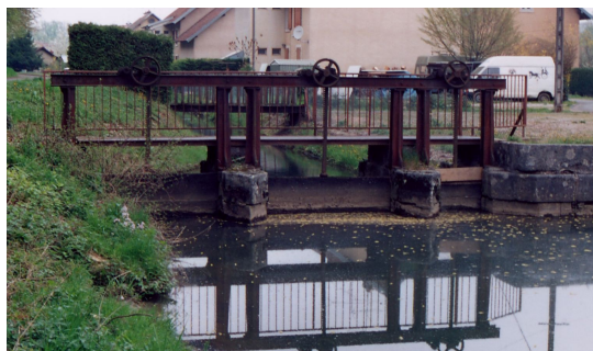
Vannes d'entrée du canal des FORGES
