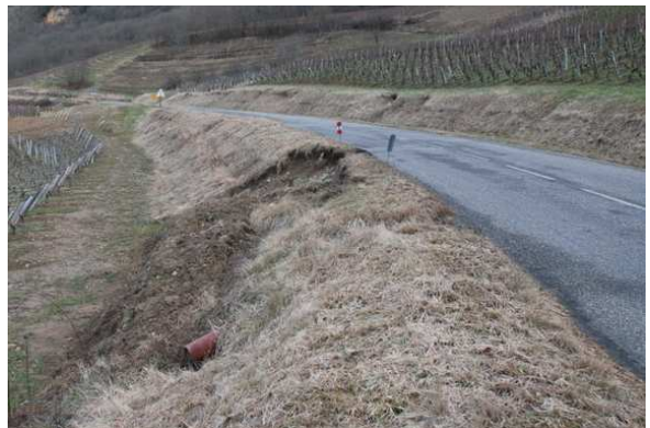
Exemple de glissement de talus routier à Château-Chinon (39) (photo BRGM).
