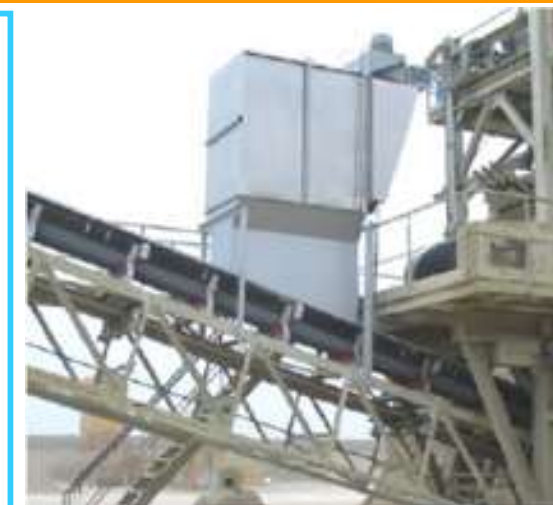
Système de dépoussiérage TRANSPAR sur l'installation de traitement (ENCEM)
