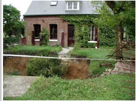
Conséquence d'un affaissement (Somme) – (Source : BRGM)
