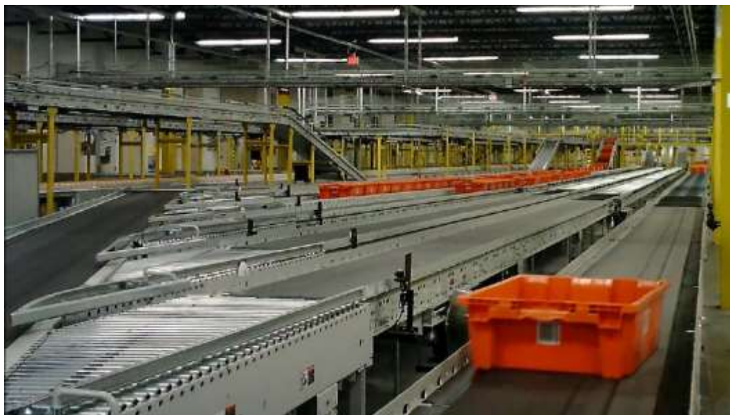
Exemple de convoyeurs sous mezzanine
